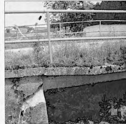
Durch einen Lastwagen wurde die Brücke bei Pfarrkofen beschädigt.
